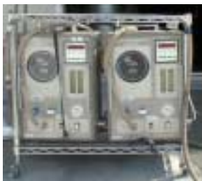
写真1 【ガスメーター・吸引ポンプ】 排ガスを吸引する装置
